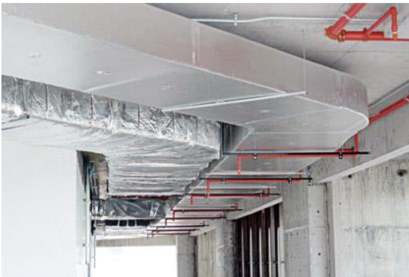
Sistema de dutos
